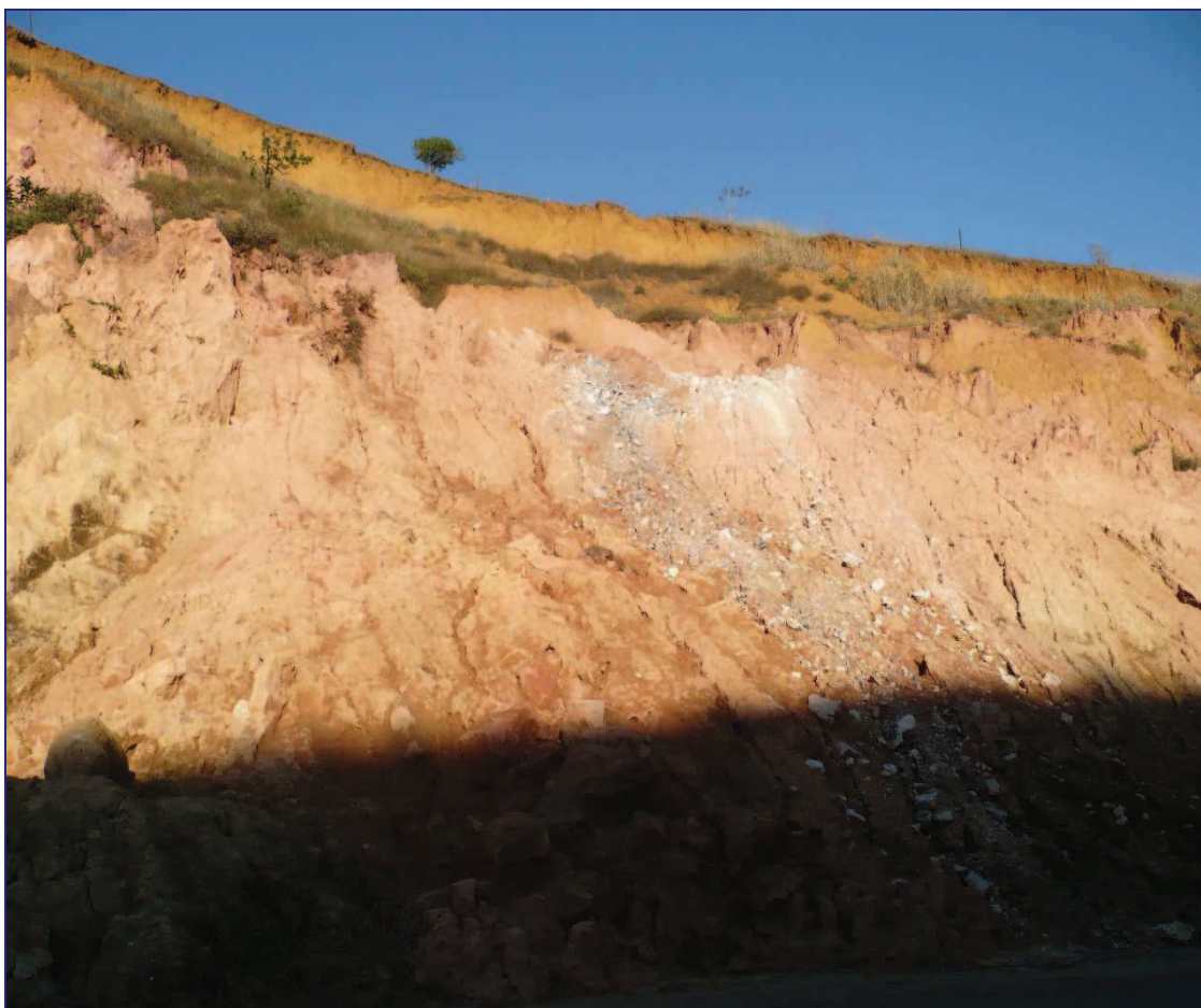
IMAGEM 24: Grande erosão a beira da estrada Miracema/Venda das Flores.
