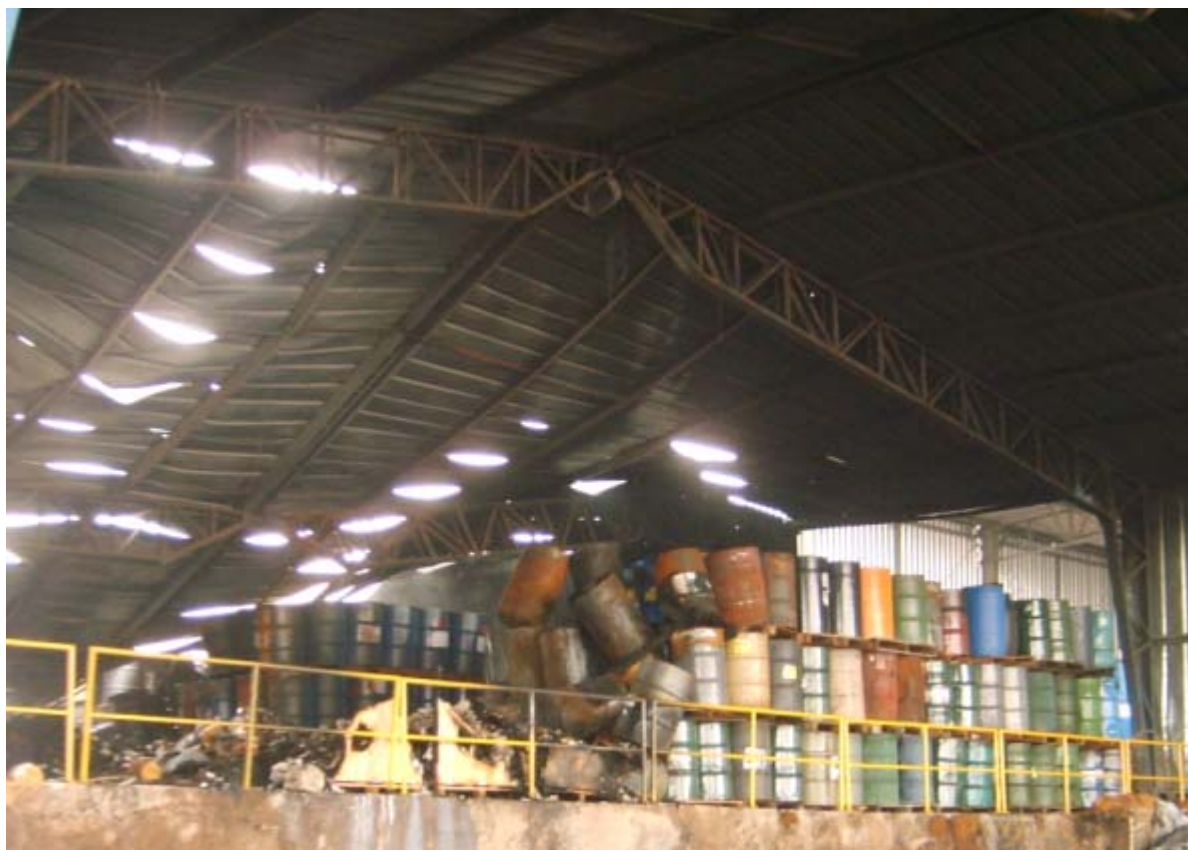
Fotografia 10: Resíduos tóxicos armazenados em galpão danificado por incêndio em área vizinha. Foto de autor anônimo, em 28/08/2007.
